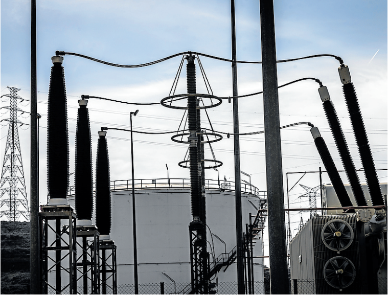
Transformador de elevación de energía eléctrica en Arrúbal. J. R.
