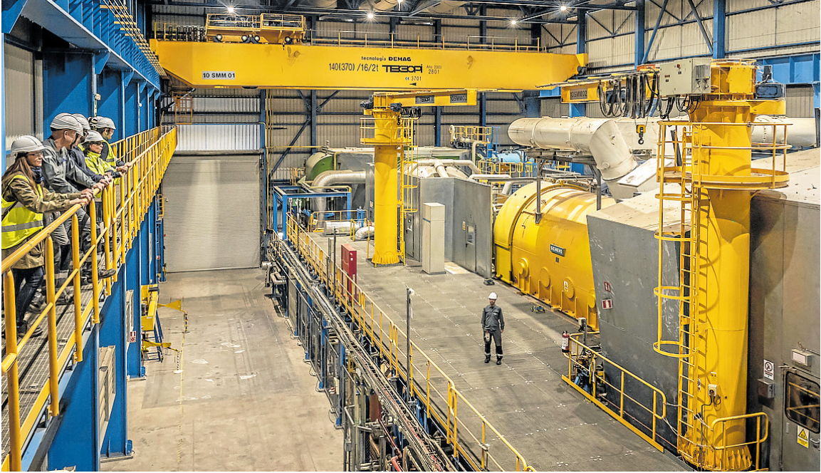
Edificio de turbina donde se alberga el equipo principal de generación eléctrica de ContourGlobal. J. RODRÍGUEZ
