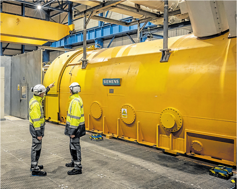
Dos trabajadores señalan el alternador eléctrico. JUSTO RODRÍGUEZ
